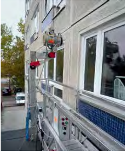
Abb. 5: Fassadenaufzug (Befahranlage) – Anwendungsbereich Maschinenrichtlinie.
