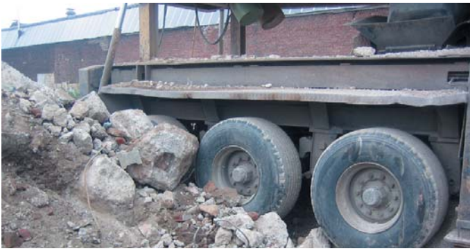
Die Gefährdungsbeurteilung hätte ermitteln müssen, dass bei Anlagenbetrieb die Reifen und damit die Standsicherheit nicht ausreichend geschützt sind.
