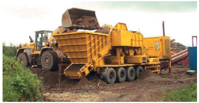
Diese Anlage erfüllt die gesetzlichen und berufsgenossenschaftlichen Anforderungen. (Fotos: Niepel)
