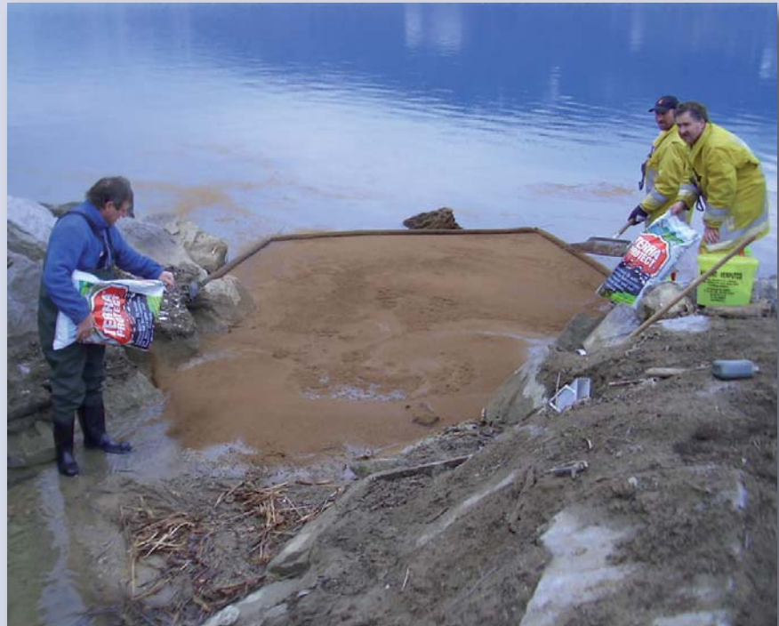
Ölunfall: Bei Bauarbeiten ist Öl ausgetreten und in den nahegelegenen See geflossen.
