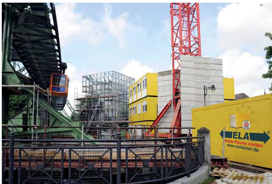
Die dreistöckige ELA-Anlage steht bei der Station Oberarmen der Wuppertaler Schwebebahn. (Fotos: ELA)
