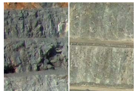
Links abgebildet eine unsaubere, rechts eine glatte Abbruchkante. (Foto: Moba)
