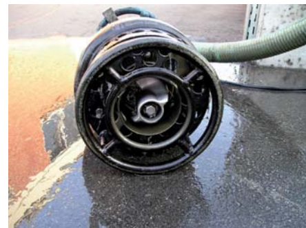
Das Rührwerk an der Einsaugöffnung der Pumpe macht den Boden fließfähig.
