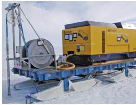
Bohreinsatz eines CompAir Kompressors in der Antarktis. Bis zu -30 °C kann mit dem Kompressor gearbeitet werden. (Foto: Alfred-Wegener-Institut/Dr. Olaf Eisen)
