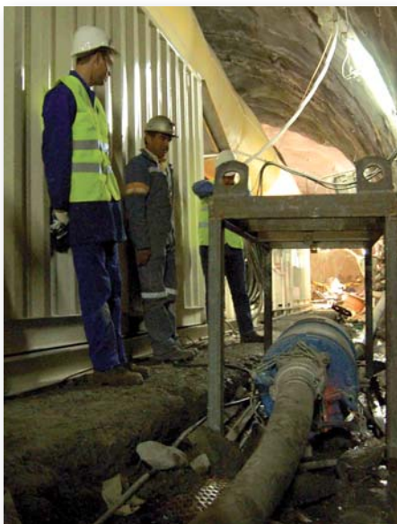
Wasserhaltung im Tunnel La Praz: Verstärkerpumpen in schlanker Bauweise mit zentriertem Flansch überwinden kilometerlange Distanzen. (Foto: Tsurumi)
