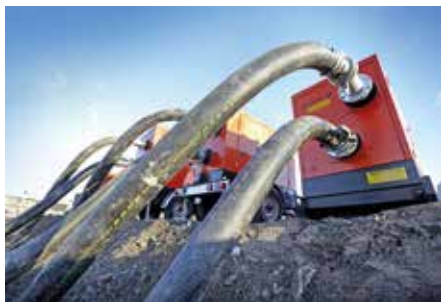
Da die Versorgung einer Papierfabrik über den üblichen Weg aufgrund von Niedrigwasser nicht mehr möglich war, verhindert die Mietanlage den Betriebsstillstand.
