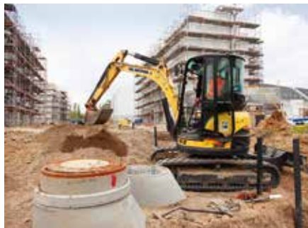
Der ViO50 von HKL wird den engen Gegebenheiten zwischen den Gebäuden gerecht.
