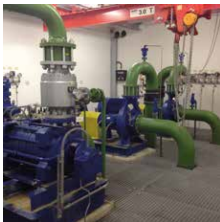
Im Skigebiet Sölden versorgt eine Pumpstation auf 2602 mSH (Fördermenge bis 300 m³/h, Förderhöhe bis 850 mWS) mit Mehrstufenspumpen, Spiralgehäusepumpen und UV-Desinfektionsanlagen von Xylem die Anlage mit dem nötigen Wasser zur Schneeerzeugung.
