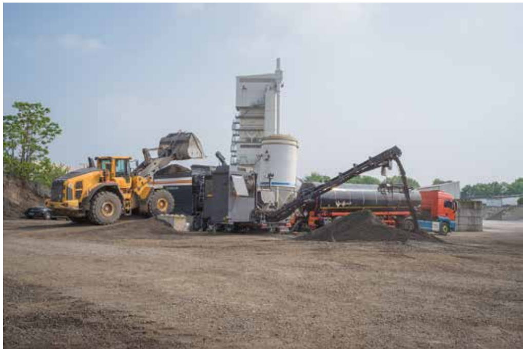
Kurze Wege: Die mobile Kaltmischanlage KMA 240i wurde baustellennah platziert und stellte aus Asphaltfräsgut unter Zugabe von Bindemitteln die neue BSM-Tragschicht her. (Foto: Wirtgen)
