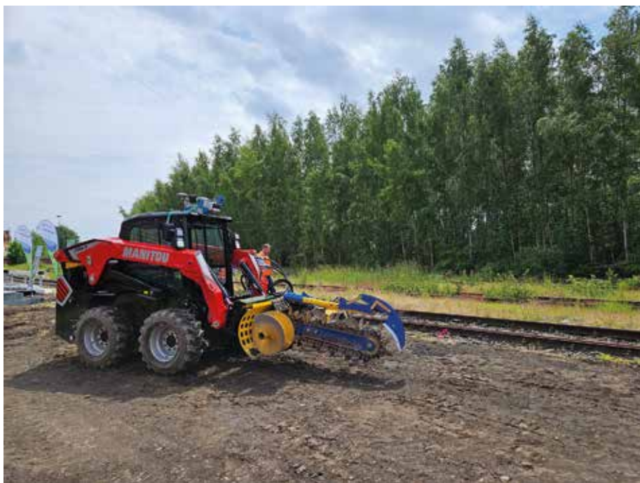
Innovation: Beim „Infrastruktur Workshop NORD“ der DB mindbox/DB InfraGO hat Manitou System zum Verlegen von LWL-Kabeln präsentiert. (Fotos: Manitou)
