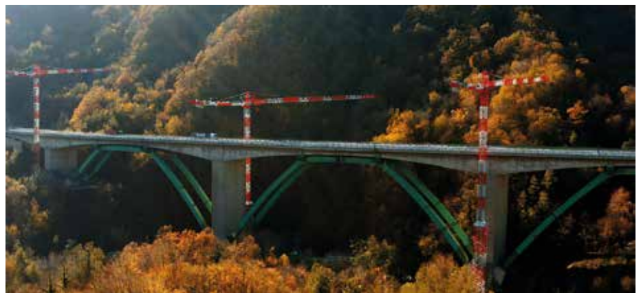
Premiere: Beim Talbrückensanierungsprojekt im italienischen Gravagna kamen Europas größte Potain-Obendreherkrane MDLT 1109 erstmals zum Einsatz. (Foto: Manitowoc)
