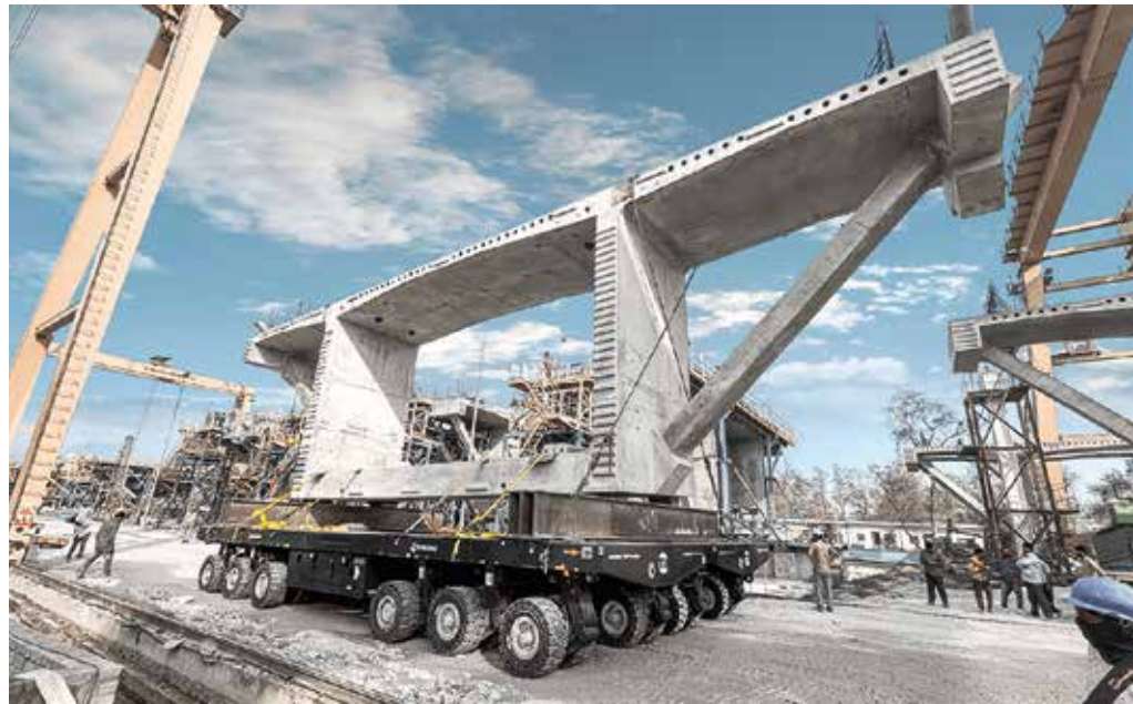
Maßarbeit: Seitlich gekuppelt befördern zwei PowerHoss Module 175 t schwere Brückensegmente bis zum Trägerwerfer. (Foto: TII)
