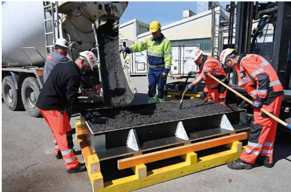
Umfangreiche Versuchsreihen: Forschungsmittelpunkt der Studie „Ökobilanz heizbarer Schalung für CO 2 -reduzierte Betone“ war ein von Doka entwickelter Prototyp einer intelligent beheizbaren Schalung. Dabei wurden Sommer- und Winterbedingungen simuliert. (Foto: Doka)
