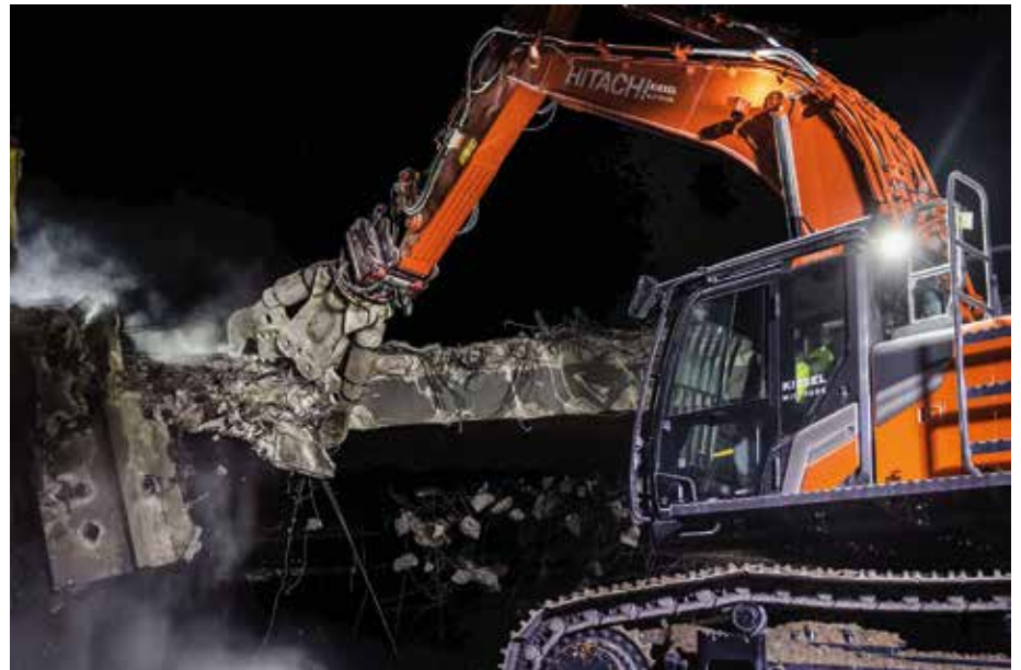
Kurzer Prozess: Der Hitachi ZX490-7 mit der Demarec DCC65 Abbruchschiere aus dem Kiesel Mietpark beim Abbruch einer Autobahnbrücke auf der A1. (Foto: Kiesel GmbH)
