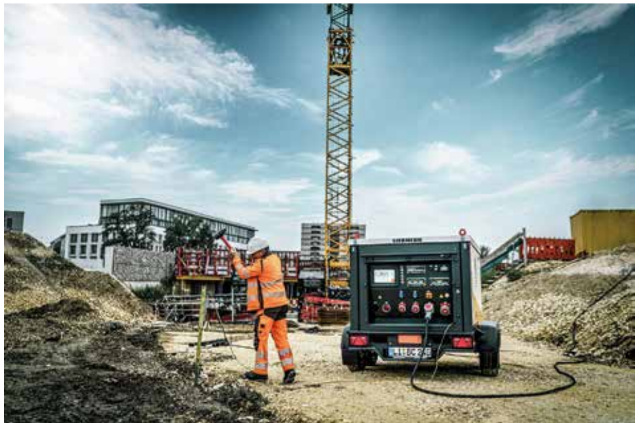
Baustelle als Energiesystem: Der Liduro Power Port entkoppelt den Energiebedarf von der Netzkapazität und macht Elektrifizierung dort möglich, wo das Netz allein nicht ausreicht. (Fotos: Liebherr)
