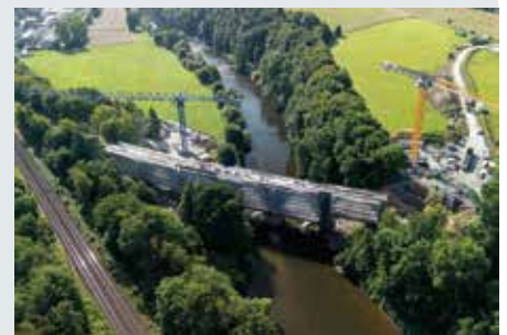
Keine Kranumsetzungen: BKL hat die beiden Schwerlastkrane an je einem Ufer der Sieg mit Ausladungen von 70 und 80 m montiert. Damit deckten sie die gesamte Brückenlänge von fast 170 m ab. (Foto: Albert Weil AG)
