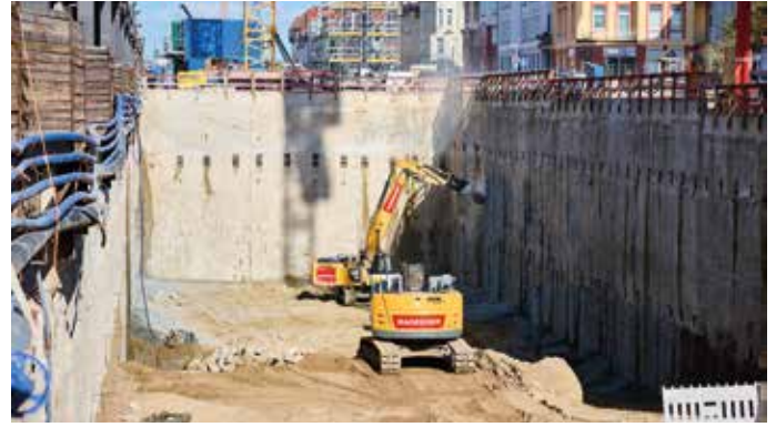
Perfekte Abstimmung: Bagger des ARGE-Partners Hagedorn bei vorbereitenden Maßnahmen für den Tunnelbau. (Foto: Hagedorn)
