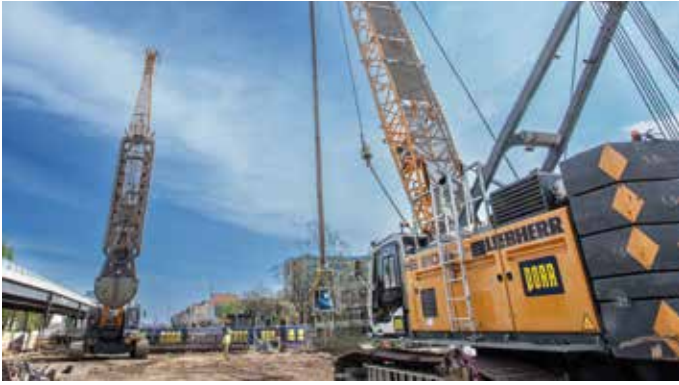
Schwieriges Areal: Im sogenannten Insel-Dock 8 laufen die letzten Schlitzwandarbeiten unter extrem beengten innerstädtischen Bedingungen. (Foto: Porr)
