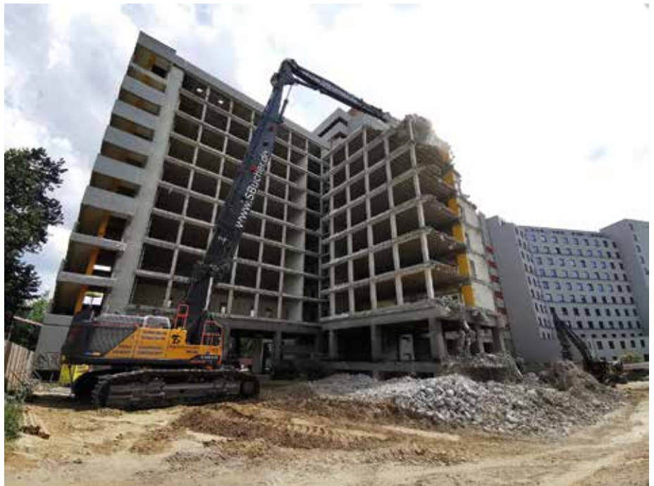
Starke Leistung: Rund 55.000 m 3 umbauter Raum mussten „An der Urania 4 – 10“ abgebrochen werden. Der Volvo EC750E HR mit seinem High Reach-Ausleger erwies sich als die perfekte Maschine. (Foto: Swecon Baumaschinen GmbH)
