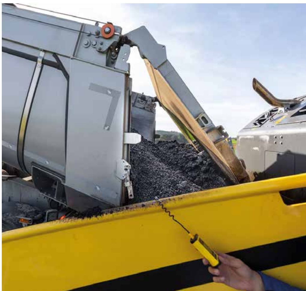
Vorteilhaft: Durch den Einbau Temperaturgesenkten Asphalts lassen sich Energie, Emissionen und Zeit einsparen. (Foto: Bomag)
