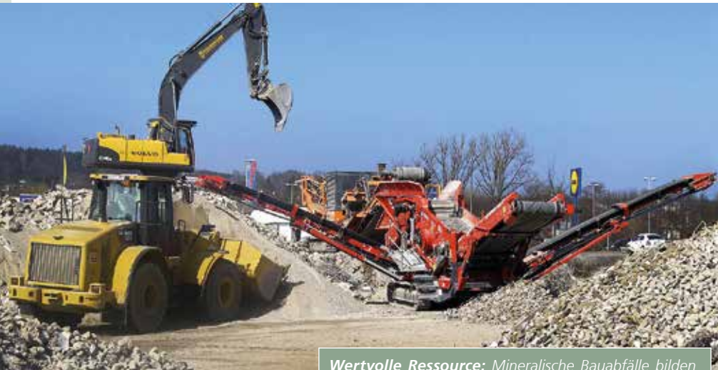
Wertvolle Ressource: Mineralische Bauabfälle bilden mit über 220 Mio. t die größte Abfallmenge in Deutschland. (Foto: Pixabay/lanaterate)
