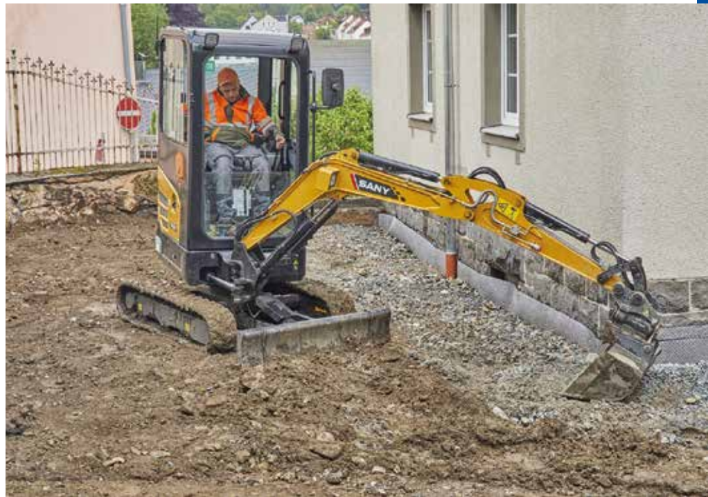
Allrounder im Einsatz: Der Sany SY18C Minibagger sichert Tobias Harbig flexible Einsatzmöglichkeiten und Unabhängigkeit von Mietstationen. (Foto: Sany)
