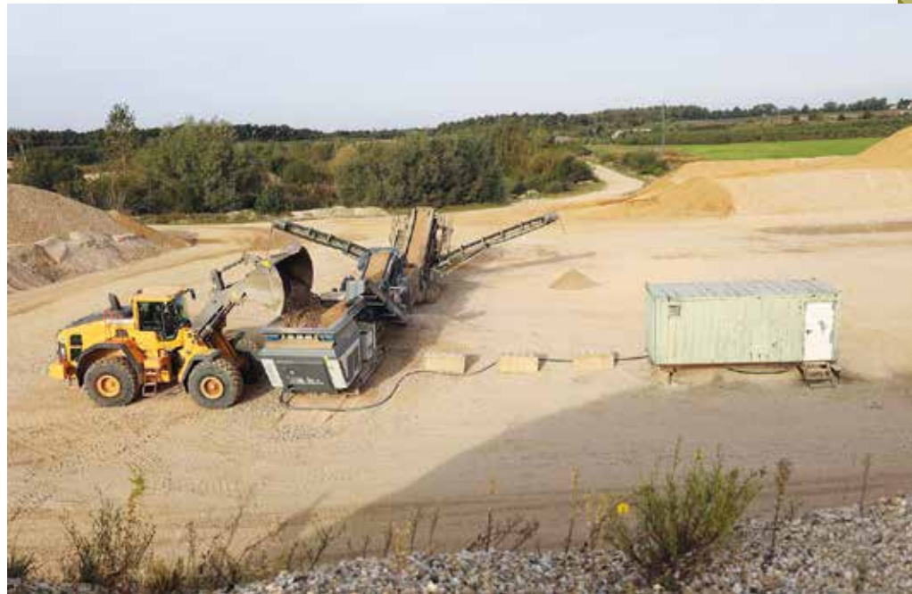
Kabelgebunden: Der RM100GO! Hybrid in der Kies-Aufbereitung im vollelektrischen Betrieb über Netzstrom. (Foto: C. Christophel GmbH)
