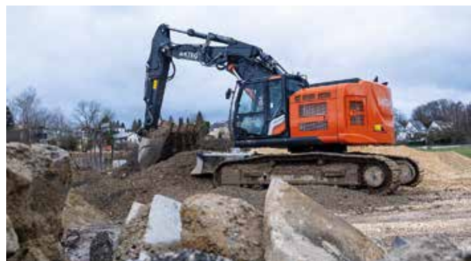
Kurzheckbagger wie der KTEG 375US-7 zeigen, wie hilfreich sich die kompakten Ausmaße auf die Arbeitsprozesse auswirken können. (Foto: Kiesel GmbH)
