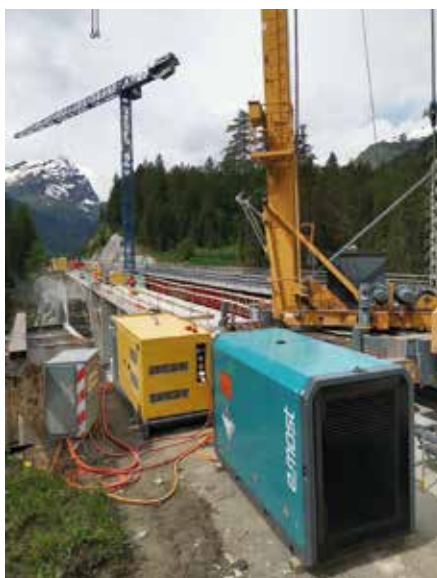
Hohe Leistung: Die mobile Batterie Butler M versorgt die Baustelle der Autobahn A13 bei Sufers in der Schweiz mit Strom.
