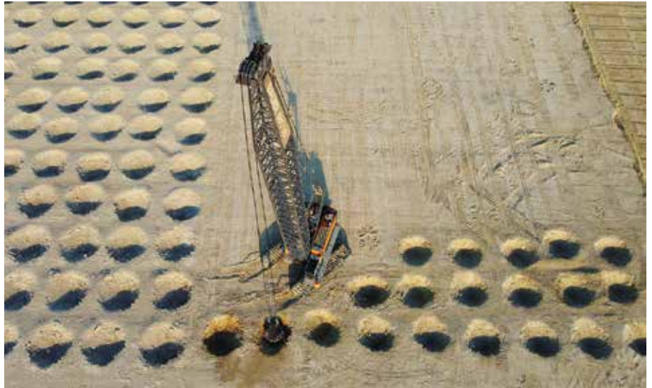
Kontrollierter Freifall: 25 t schwere Pounder schlagen bis zu fünfzehnmal auf dem Grund ein. Die kinetische Energie wirkt bis in tiefere Bodenschichten ein und führt zu einer Verdichtung.
