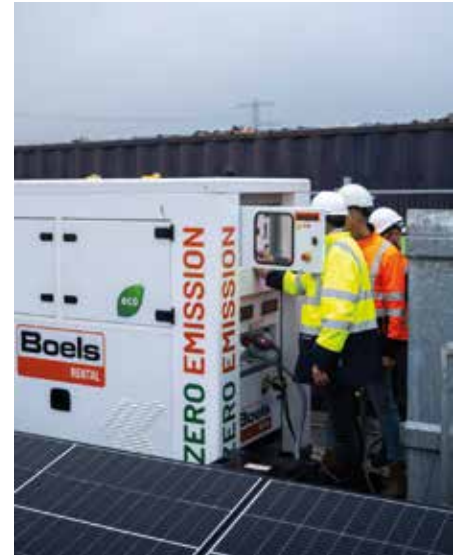
Hybride Lösung: Omexom wählte eine netzunabhängige Stromversorgung mit Solarzellen und einem Akkupack als Speicher. Im Bedarfsfall schaltete sich ein mit HVO100 betriebener Generator ein. (Foto: Boels)
