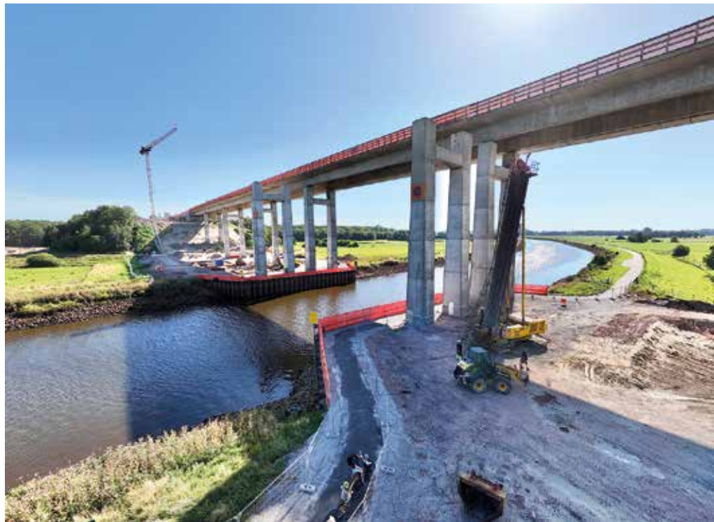
Neues Konzept: Die alte Huntebrücke stand auf 36 Einzelpfeilern, der Ersatzneubau künftig auf 14 V-Pfeilern. (Fotos: PORR)
