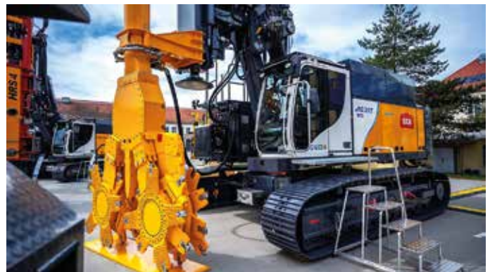
Die eRG 21 T hybrid der RTG Rammtechnik zeigt, wie eine Baustelle fast ohne Lärm und Abgase funktioniert.
