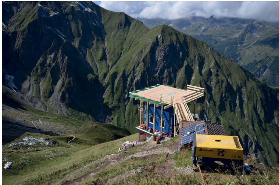
In über 2000 m Höhe: Rückbau mit Stemmarbeiten und Neubau der Fundamente der neuen Wanderhütte Walterberger-Haus bei Oberstdorf. Während der Arbeiten wohnten die Mitarbeiter im Container unter der Heli-Plattform. (Fotos: CompAir)
