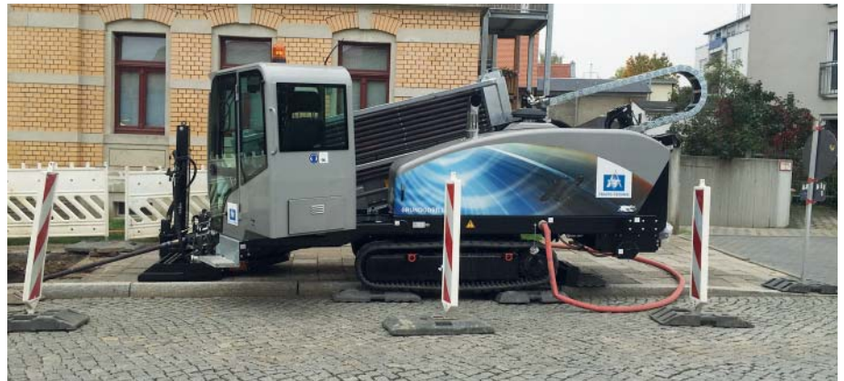
Leistungsfähigkeit überzeugt: Mit der Spülbohranlage Grundodrill11XP wurden die insgesamt 365 m Rohr in nur 30 Stunden grabenlos unter dem Straßenbelag verlegt. (Foto: Tracto Technik)
