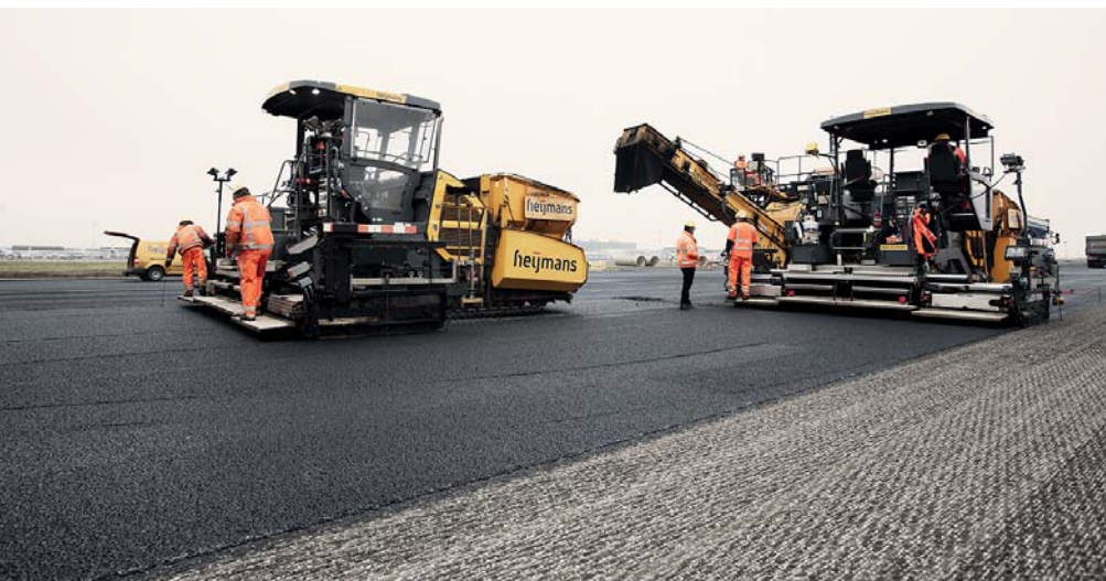
Zeit ist Geld: Für die Neuasphaltierung der Startbahn am Flughafen Schiphol wurden sieben Wochen veranschlagt. (Fotos: Atlas Copco)
